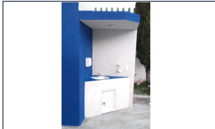
VISTA EXTERIOR ESTACION LAVADO DE MANOS
